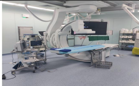
急诊科 DSA 设备
